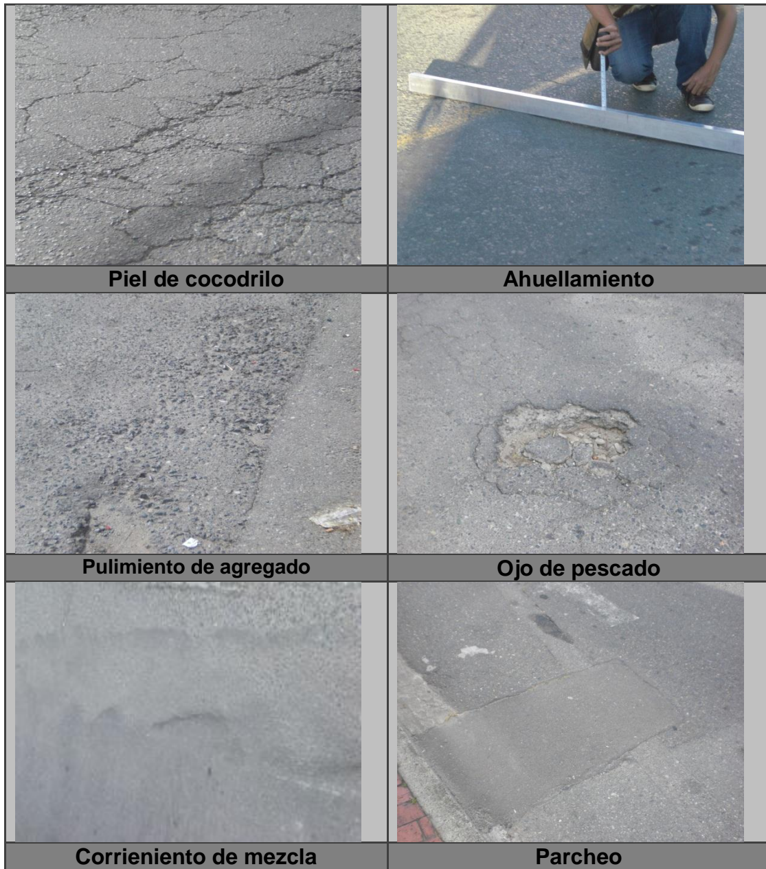
Figura 11. Tipos de daños más frecuentes.
