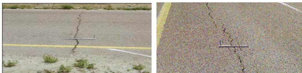
Figura 12. Fisuras y Grietas
