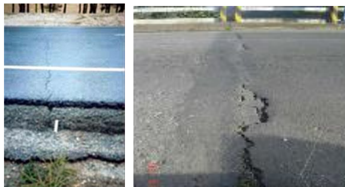
Figura 18. Fisura por reflexión de juntas
