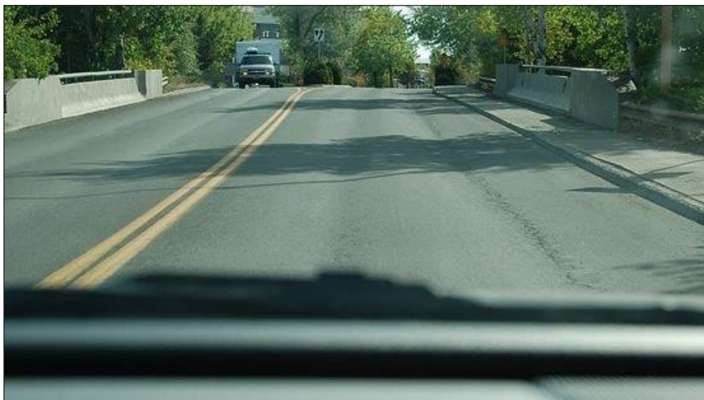
Figura 7.1. Daños en una capa de rodadura causados por neumáticos con tachones, Oregon, USA
