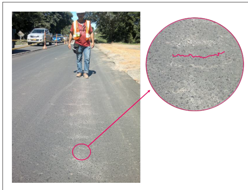
Figura 13.2. Patrón de fisuración transversal en la huella del tráfico. Carretera Yopal – Aguazul – Hato Corozal
