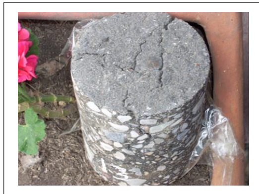
Figura 13.3. Núcleo extraído en sector con fisuras transversales, muestra que ellas se inician en la parte superficial y avanzan hacia abajo (Carretera Bogotá-Ibagué, Colombia)
