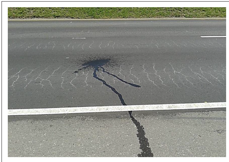
Figura 13.1. Fisuración transversal invertida concentrada únicamente en las huellas de tráfico, sin presentar ahuellamiento sucedida prematuramente. Carretera Bogotá-Ibagué, Colombia
