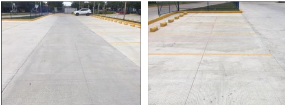
Figura 25.15. Losas optimizadas. Parqueadero C.C. Santo Tomás
