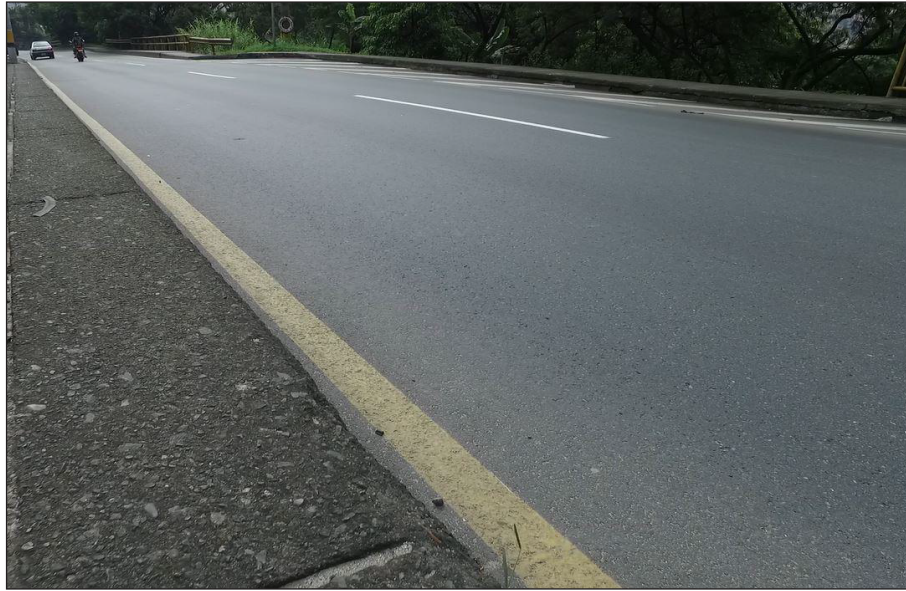
Figura 9.6. Autopista norte costado oriental, 6 meses después de la aplicación Fuente: elaboración propia.
