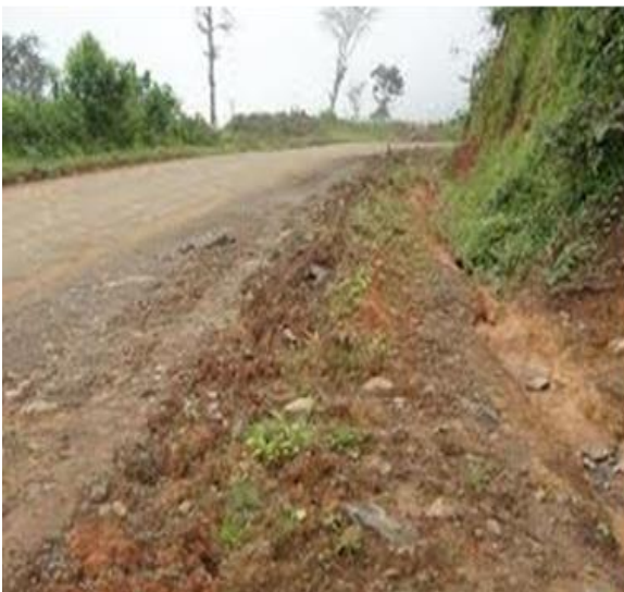
Figura 7. Cuneta no revestida
