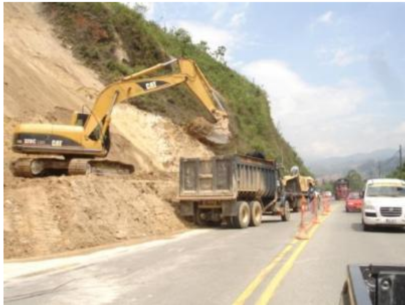
Fotografía 12. Volqueta por debajo del nivel de sustentación de la retroexcavadora
