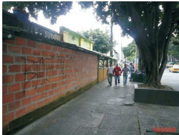
Fotografía 9 andenes deteriorados y en mal estado, carrera 70 con circular 1
