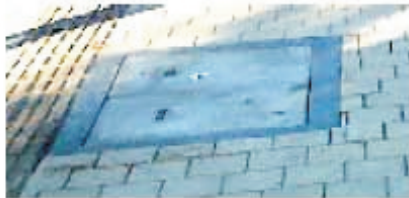
Figura 6. Caja de inspección
