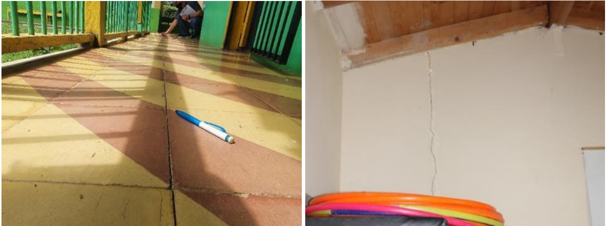
Figura 20. Daños en la estructura del CER Álvaro Ardulio Naranjo (ID 2)
