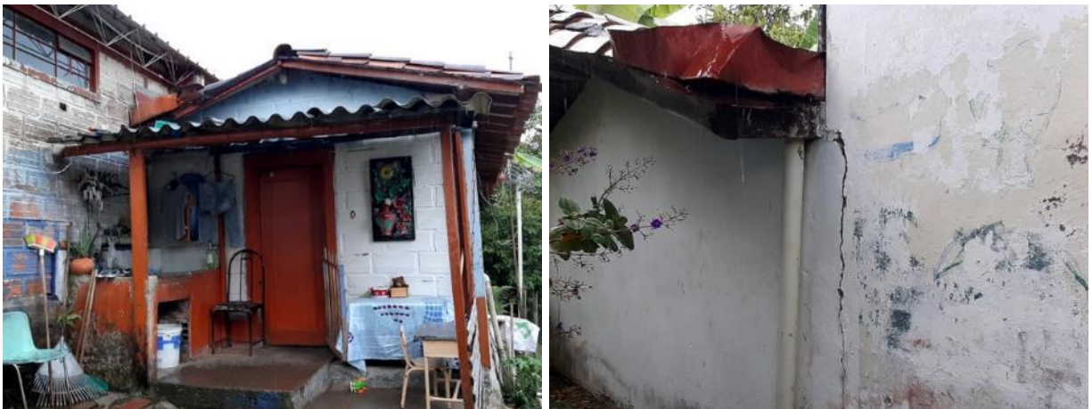
Figura 21. Daños en la estructura del CER Guacamayal (ID 12)
