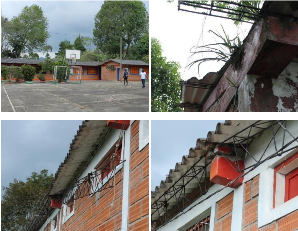
Figura 25. Estado de la cubierta del CER Palenque (ID 10)
