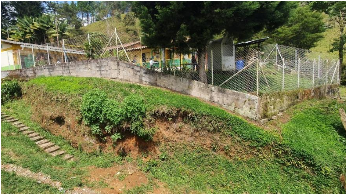
Figura 60. Deslizamiento en CER Álvaro Ardulio Naranjo
