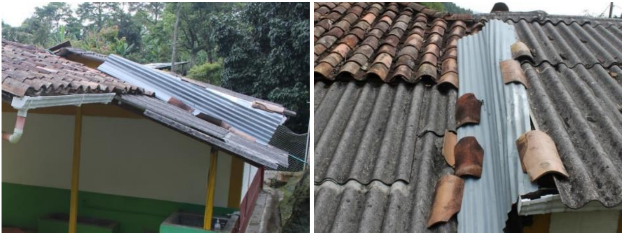
Figura 22. Estado de cubierta del CER Álvaro Ardulio Naranjo (ID 2)
