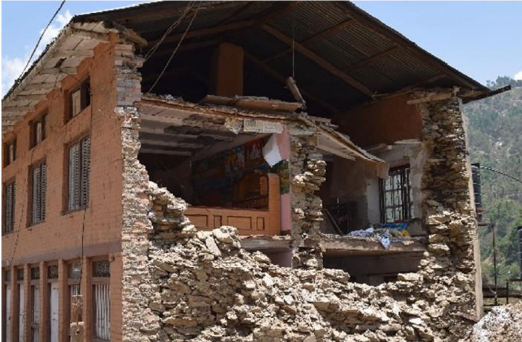
Figura 27. Apariencia de falla fuera del plano. Fuente: Giordano et al. (2020)
