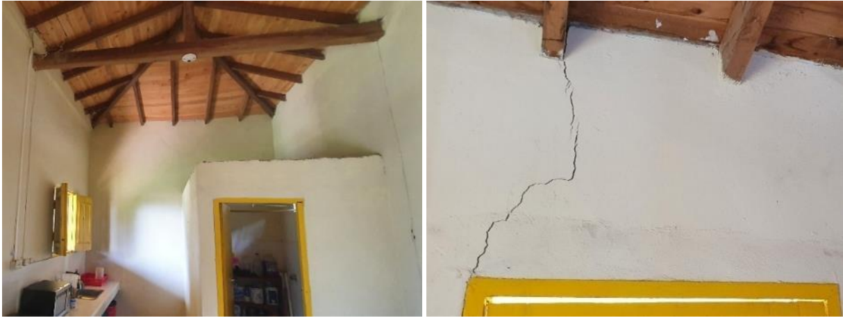
Figura 61. Apoyo de cubierta y afectaciones de esta, CER Álvaro Ardulio Naranjo
