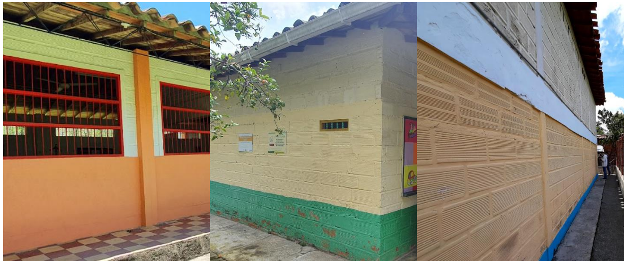
Figura 31. Condiciones de muro de frontera encontradas en campo
