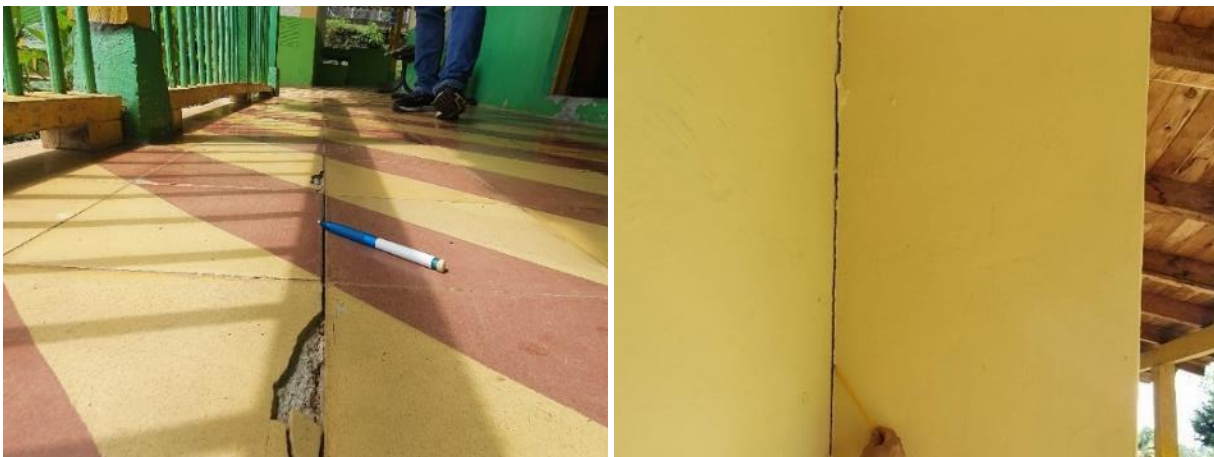
Figura 62. Afectaciones en módulo de mampostería simple, CER Álvaro Ardulio Naranjo
