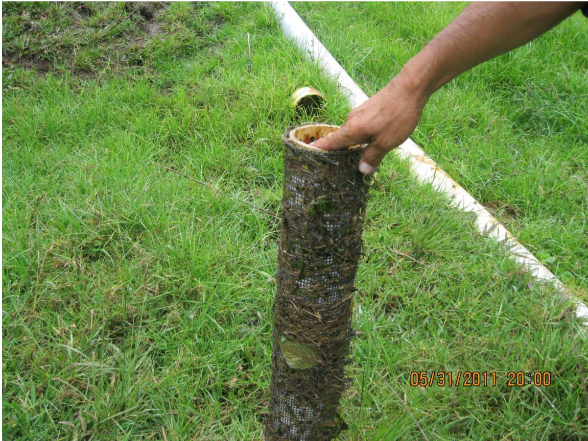
Foto filtro de arena.
