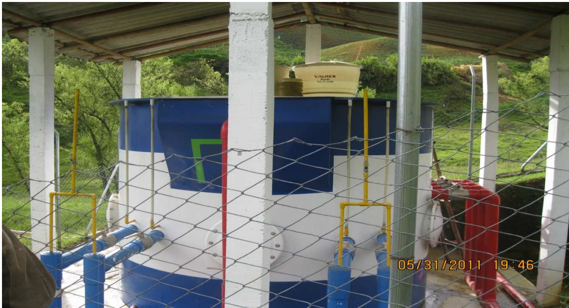
Foto . Filtro potabilizador.
