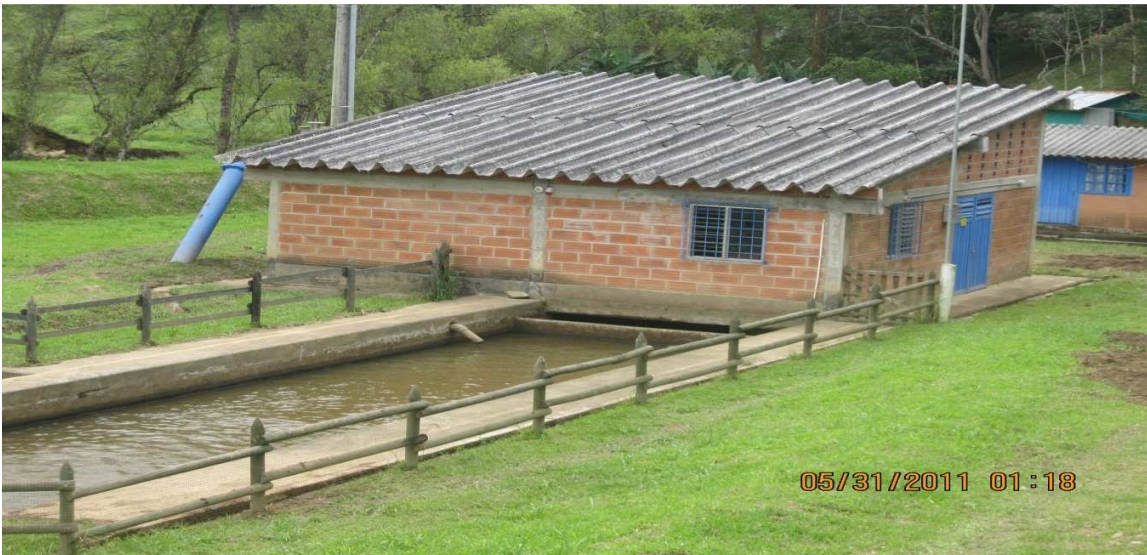
Foto Tanque desarenador.
