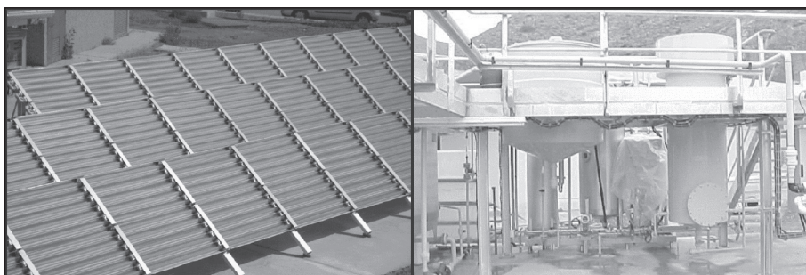
Figura 1. Vistas de la planta de demostración para el tratamiento combinado foto-Fenton solar/biológico. Campo de colectores solares (izquierda), tanque de acondicionamiento y reactor de biomasa inmovilizada (derecha).
