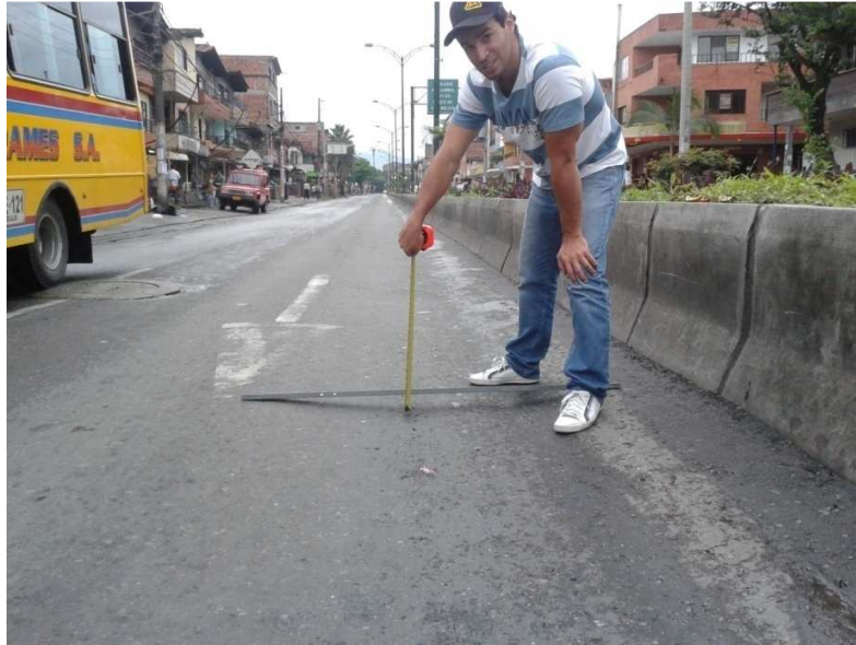
Foto 19. Ahuellamiento del pavimento en la carrera 52 con calle 85 Costado oriental. Vía objeto de estudio.
