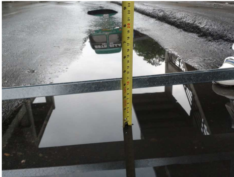
Foto 4: Detalle de la deformación del pavimento de 9 cm, calzada central Sector Estación del Metro Itagüí.
