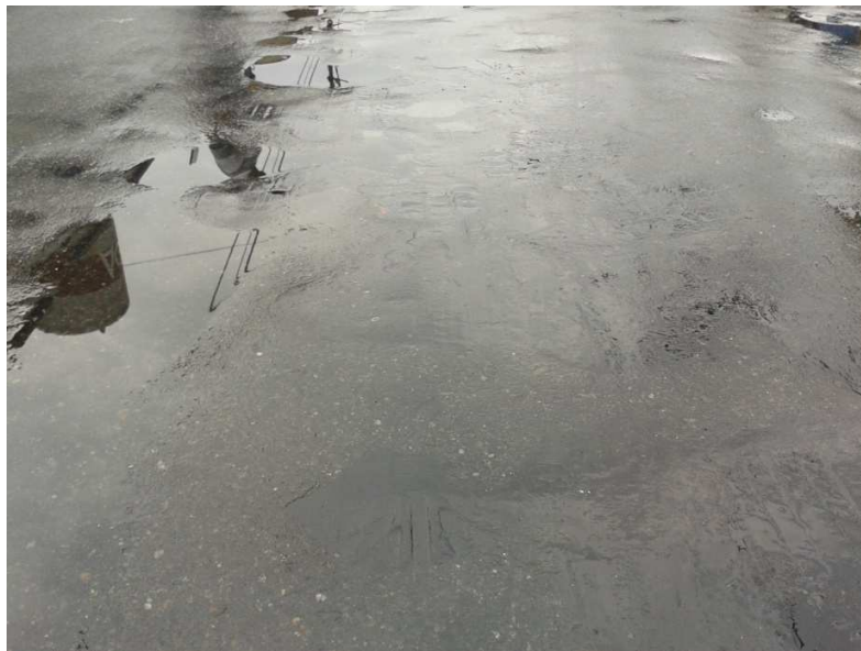
Foto 10: Detalle exudación de asfalto sobre el pavimento, Calle 46 con carrera 49
