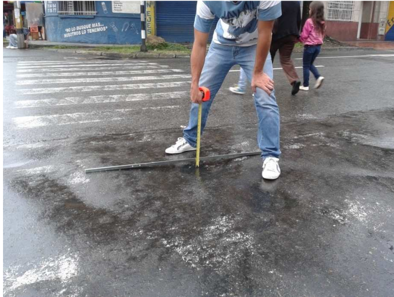
Foto 13: Medición de la deformación del pavimento. Calle 45 con carrera 50 A.
