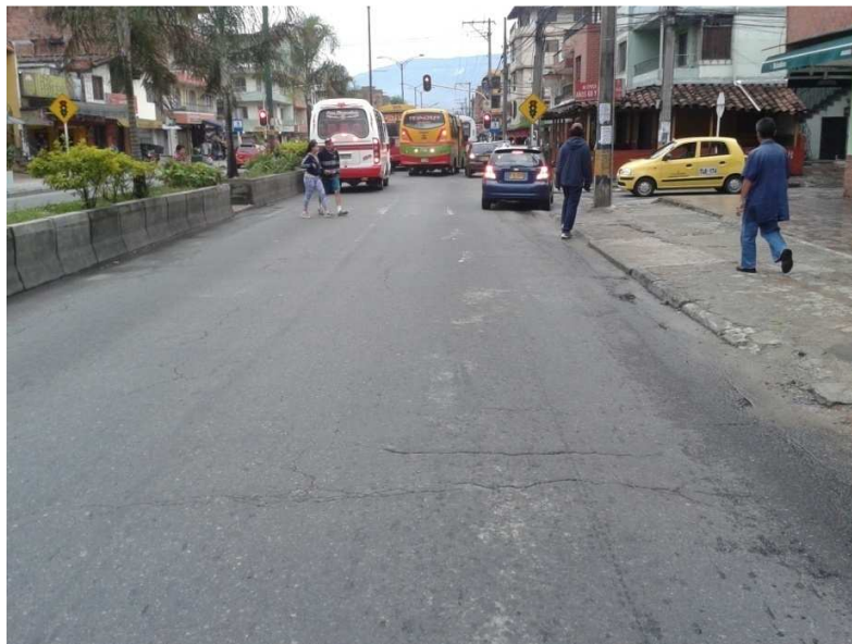
Foto 16: Fisuras transversales en la carrera 52 con calle 78 Costado oriental. Vía objeto de estudio.
