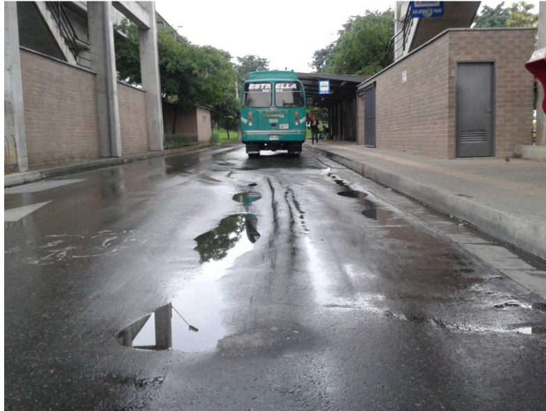
Foto 3: Ahuellamiento, deformación y desplazamiento de la mezcla asfáltica. Estación del Metro Itagüí calzada central.
