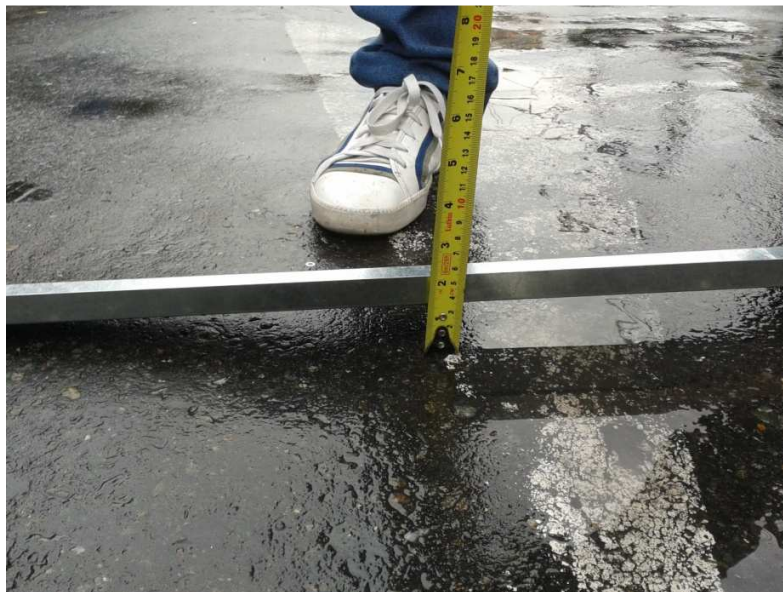
Foto 8: Detalle de la deformación del pavimento de 4 cm, Calle 46 con carrera 49
