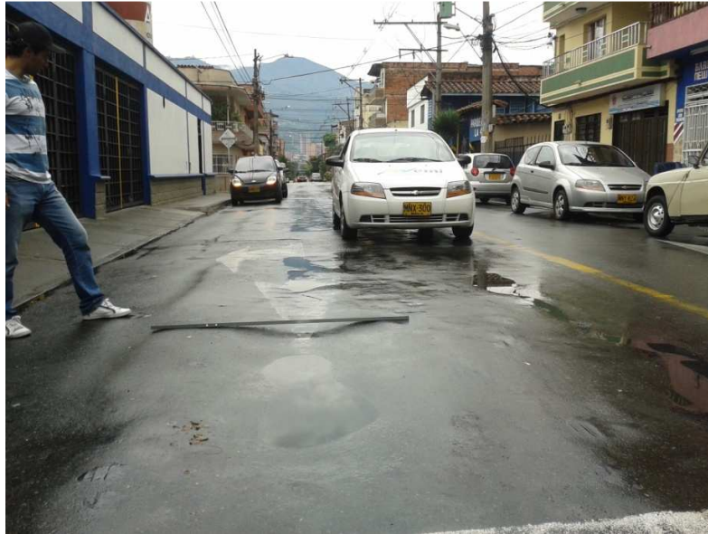
Foto 7: Ahuellamiento, deformación y desplazamiento de la mezcla asfáltica. Calle 46 con carrera 49
