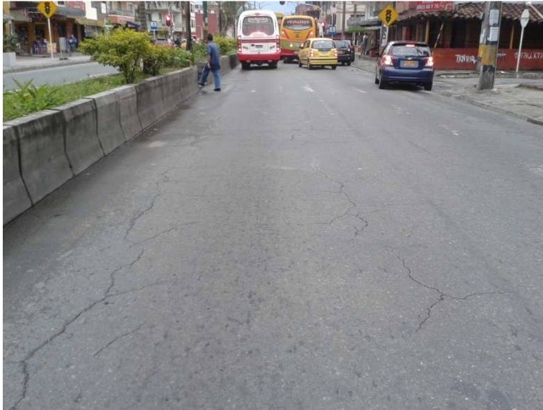
Foto 17: Fisuras transversales en la carrera 52 con calle 80 Costado oriental. Vía objeto de estudio.
