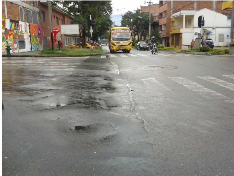
Foto 11: Desplazamiento de la mezcla asfáltica. Calle 45 con carrera 50 A
