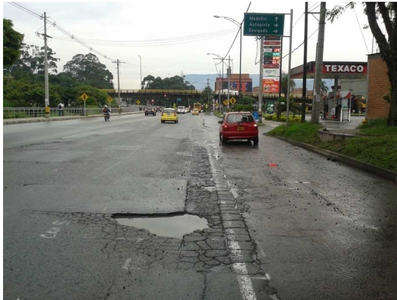
Foto 15: Bache en la carrera 52 con calle 60 Costado oriental. Vía objeto de estudio.
