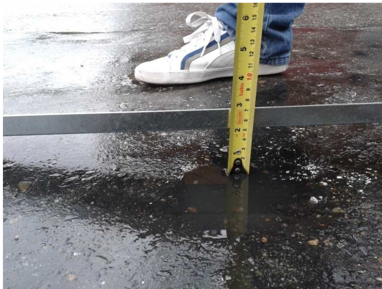
Foto 14: Detalle de la deformación del pavimento de 5 cm, Calle 45 con carrera 50 A
