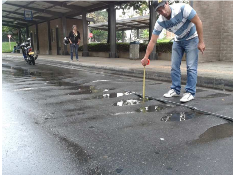
Foto 5: desplazamiento transversal de la mezcla asfáltica. Estación del Metro Itagüí calzada central.
