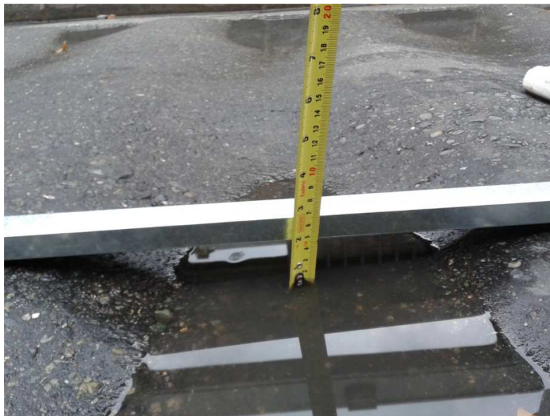
Foto 6: Detalle de la deformación del pavimento de 5 cm, calzada central Sector Estación del Metro Itagüí.
