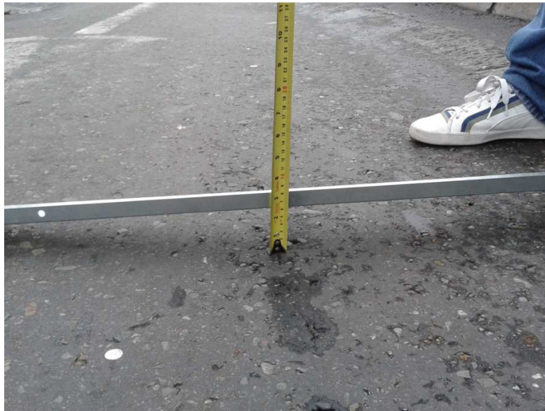
Foto 20. Detalle Ahuellamiento del pavimento en la carrera 52 con calle 85 Costado oriental, profundidad 6 cm. Vía objeto de estudio.
