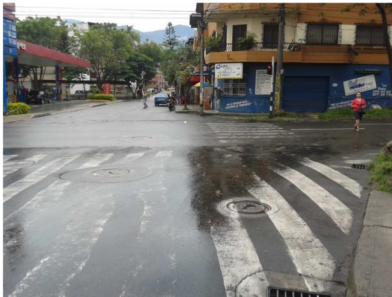
Foto 12: Otro ángulo, Desplazamiento de la mezcla asfáltica. Calle 45 con carrera 50 A. Se observa la deformación de la pintura de la cebra sobre el pavimento.
