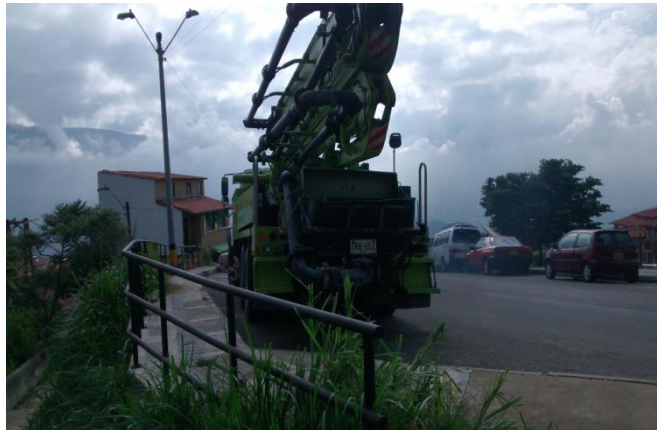
11. Autobomba: En este caso no se verifico la interferencia con el alumbrado público.
