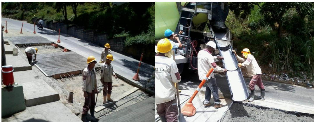
10. Vaciado de losas de concreto en forma alternada por módulos año 2012 Medellín- Colombia
