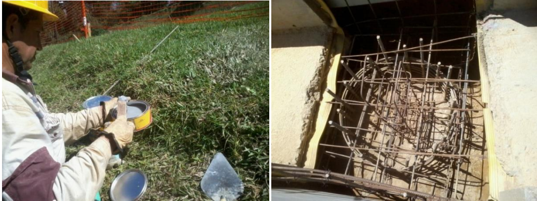
9. Construcción de la tubería de impulsión Ayúra- el Chocho utilización de Sikadur 32 para vaciado de cabezote.
