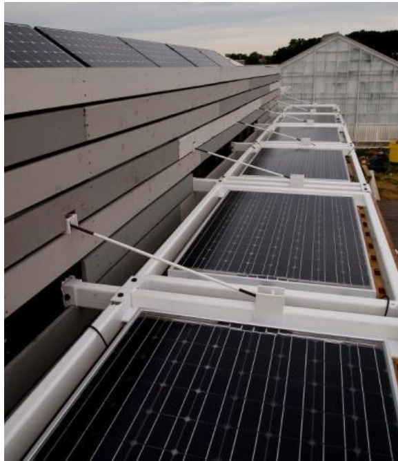
Imagen 50. Panel solar en cubierta
