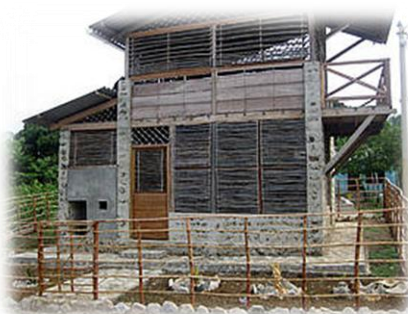
Fotografía 1. Edificación en Isla Fuerte, corregimiento de Cartagena. Fuente: Cortesía Grupo Gemma, en (Ruiz Pérez, 2011)
