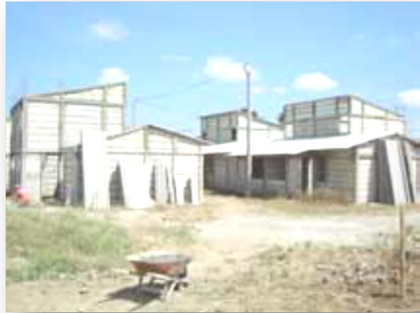
Fotografía 7. Panorámica de instalación de prefabricados elaborados con eco-cemento, proveniente del reciclaje de cenizas volantes de hornos industriales. Palmira, Valle del Cauca Fuente (Bedoya, S.f.)
