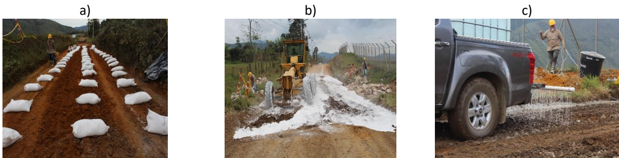
Figura 2.3 a) Aplicación estabilizante en seco, b) Homogenización de la mezcla, c) Humectación de la mezcla Fuente: Elaboración propia
